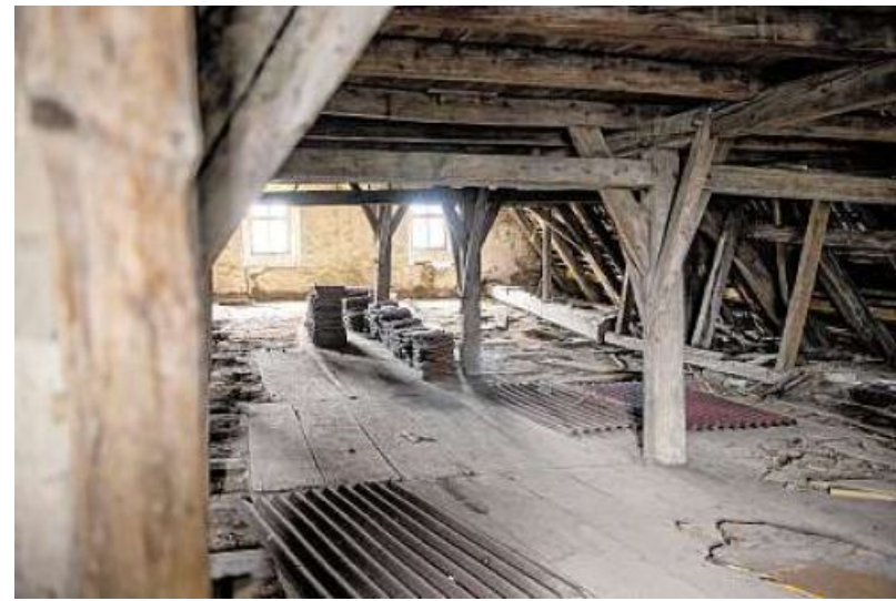
Der spätgotische Dachstuhl des Gebäudes ist eines der besonderen Merkmale des Gebäudes. Foto: Fabian Gebert
