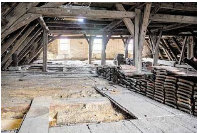
Der gotische Dachstuhl des Gebäudes am Marktplatz 19 hat unter der Witterung und mangelnder Instandhaltung bereits deutlich gelitten.
